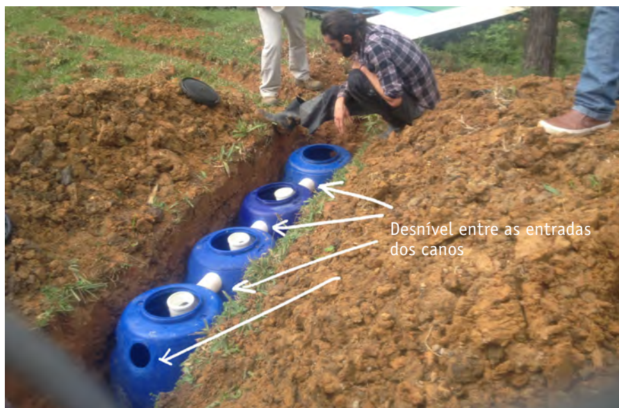
Foto 19 – Exemplo das bombonas com desnível entre as entradas dos canos nos galões.
