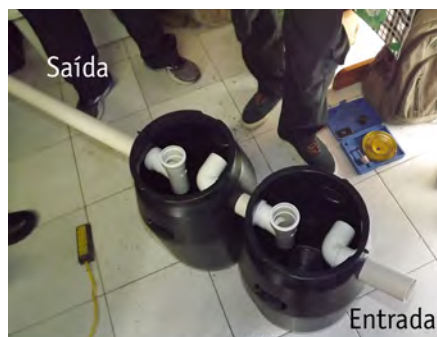
Foto 6 – Exemplo de caixa de gordura feita com galão.
