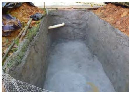
Foto 24 – Exemplo da BET impermeabilizada com o cimento.
