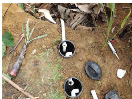
Foto 7 – Caixas de gorduras enterradas e com o cano de saída para um Círculo de Bananeiras.
